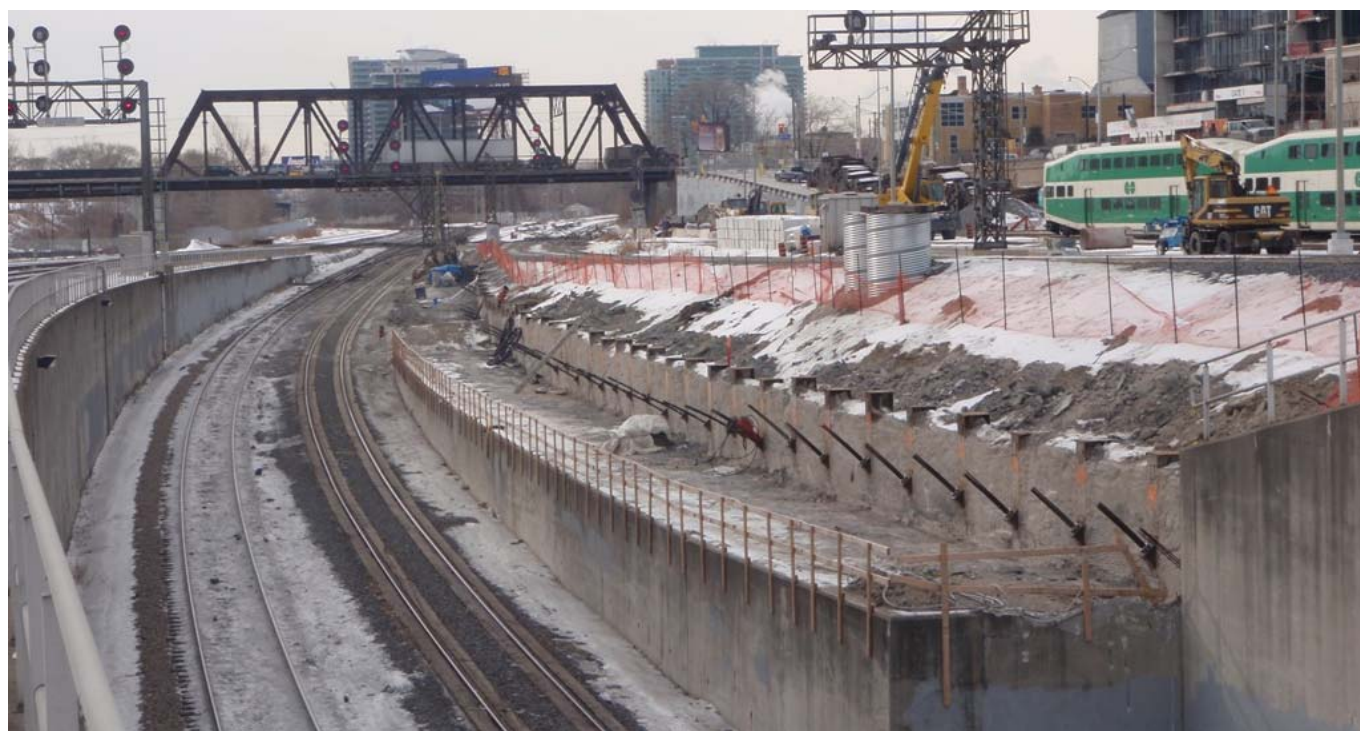
Construction du mur de soutènement situé à l'est du passage inférieur de Spadina (orientation ouest)
